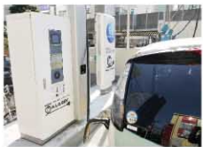
EVの急速充電器を設置している店舗はめずらしい
